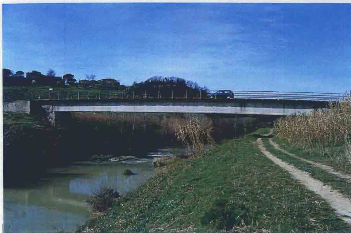
Foto 14 - Ponte di Via Molin Nuovo. Si possono notare i resti di un vecchio pilone nell'alveo del F. Elsa.
